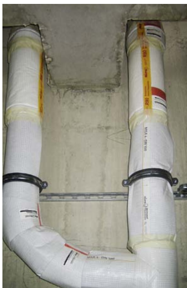
Öffnungen und Schlitzte in den Bauteilen bergen ohne technische Schutzmaßnahmen zahlreiche Gefahren im Brandfall.
