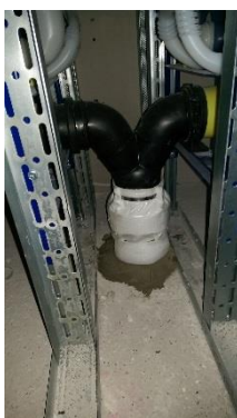
KMI_Missel_Fachbeitrag_Brandschutz_3.jpg Materialübergänge, wie hier in der Falleitung, müssen am nicht brennbaren Rohr rauch- und feuerdicht abgesichert werden. Foto: Missel.
