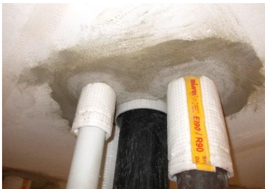
KMI_Missel_Fachbeitrag_Brandschutz_1.jpg Missel Brandschutz-Dämm-Manschetten im eingebauten Zustand mit 20 mm Abstand untereinander. Foto: Missel.
