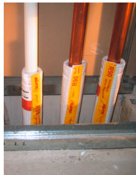
Bild 21 Deckendurchführung mit R90-Brandschutzmanschette (Missel Brandschutz-Dämm-Manschette BSM-R90)
