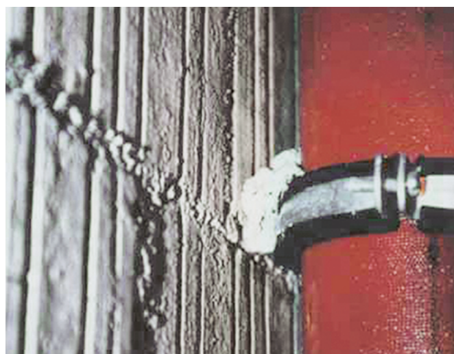
Bild 37 Schallbrücke zwischen einer Abwasserleitung und dem Baukörper, bei der die körperschallentkoppelnde Befestigungsschelle durch den herabgefallenen Mörtel überbrückt wird
