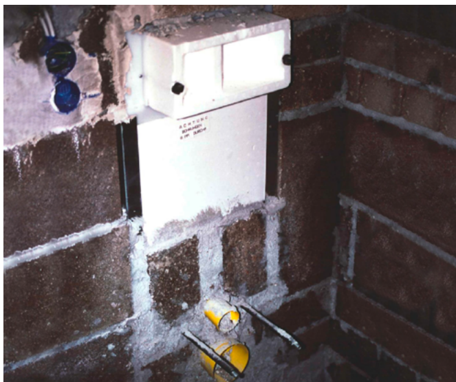
Bild 50 Eingemauerter WC-Spülkasten ohne Körperschall-entkoppelung
