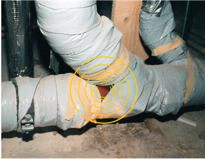
Bild 38 Unvollständige Dämmung an einem Abwasserabzweig
