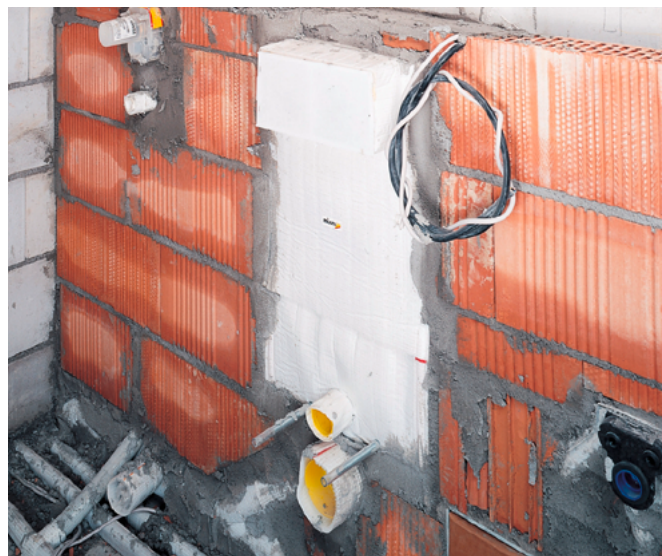
Bild 51 Eingemauerter WC-Spülkasten mit Missel Körperschall-entkoppelung MSWC
