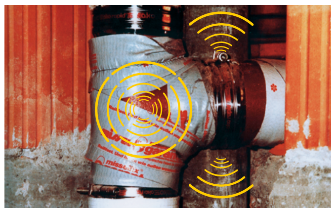
Bild 16 Körperschallbrücke durch unvollständig ausgeführte Dämmung
