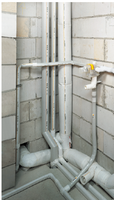
Bild 61 Konventionell und teilweise auf der Rohdecke verlegte und mit Missel Dämmungen wärme- und schallgedämmte Rohrleitungen
