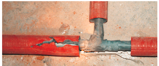
Bild 28 Eine gerissene, lückenhafte Rohrdämmung führt häufig zu Schallbrücken und zur Körperschallübertragung in den Baukörper
