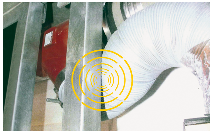
Bild 15 Körperschallbrücke einer Luftleitung mit dem Baukörper über ein Schienensystem
