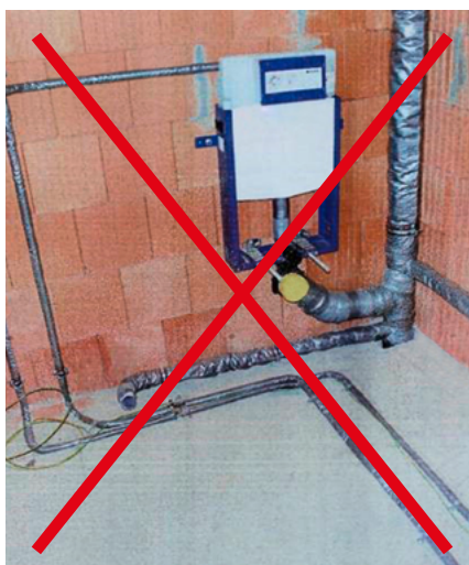
Bild 54 Ein ungedämmter WC-Spülkasten führt trotz gedämmter Rohrleitungen zu einer Erhöhung des Installations-Schallpegels
