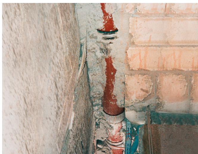
Bild 36 Geschosshohe Schallbrücke durch Einmauerung von Abwasserrohren
