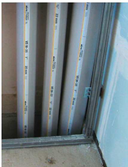
Bild 20 Rohrleitung im Schacht (Misselon-Robust 035)
