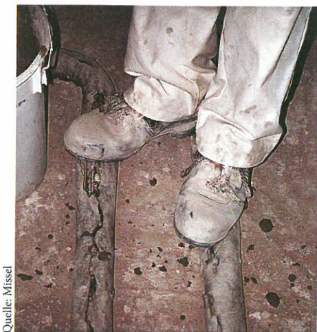
Bild 6: Gefahrenzone Baustelle: Ungedämmte Rohrleitungsabschnitte im Fußboden sollten unbedingt vermieden werden. Ansonsten besteht durch eindringenden Schmutz und Rissbildung die Gefahr von Schallbrücken und Wärmeverlusten.
